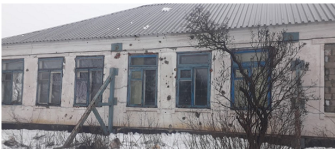
Рис. 7. Неідентифікована пошкоджена будівля. Фото: Наливайко В. / Google Maps.
