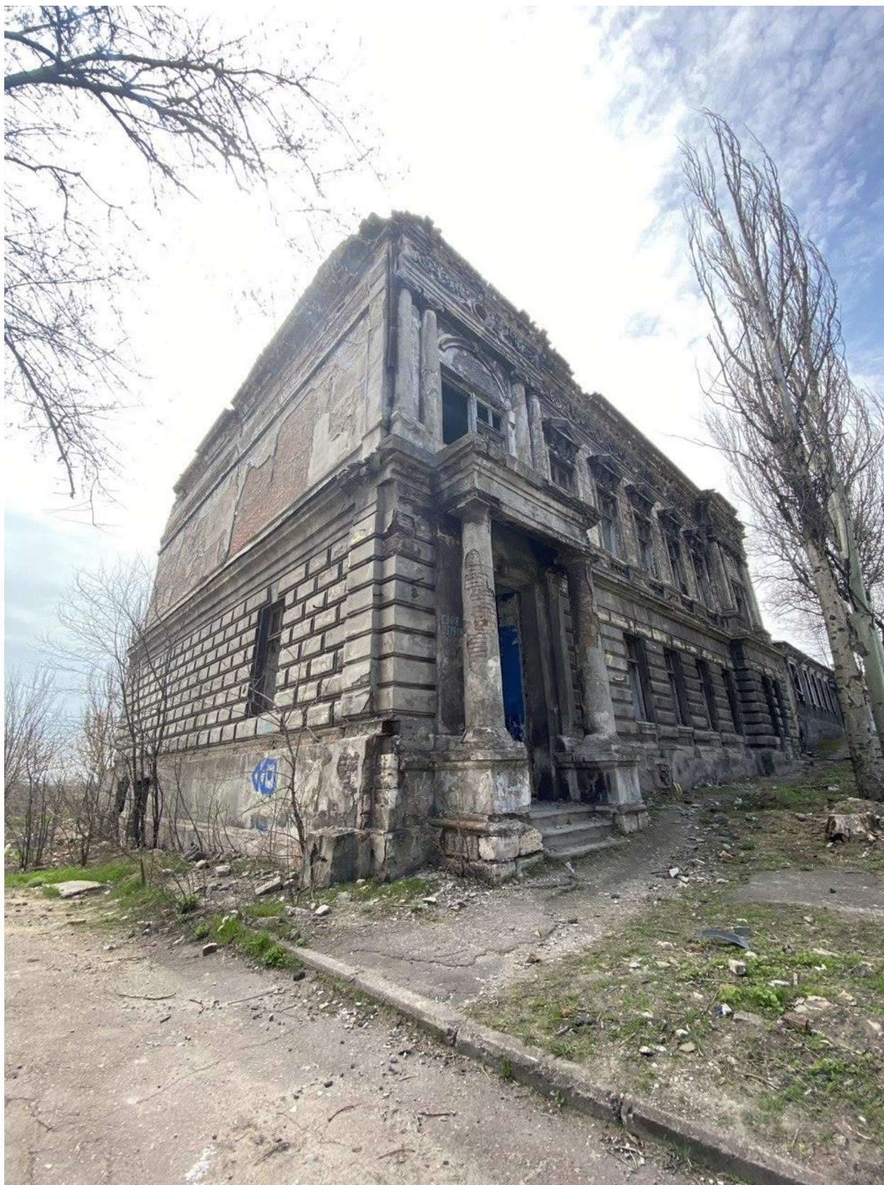
Додаток 121. Колишній будинок відомого судновласника Петра Регіра на довоєнних світлинах Н.Афанасьєвої (від 18 квітня 2021 року);
